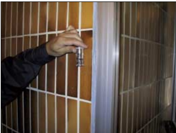
Bild 2. Invändig fog i trapphus Västmannagatan 44.
