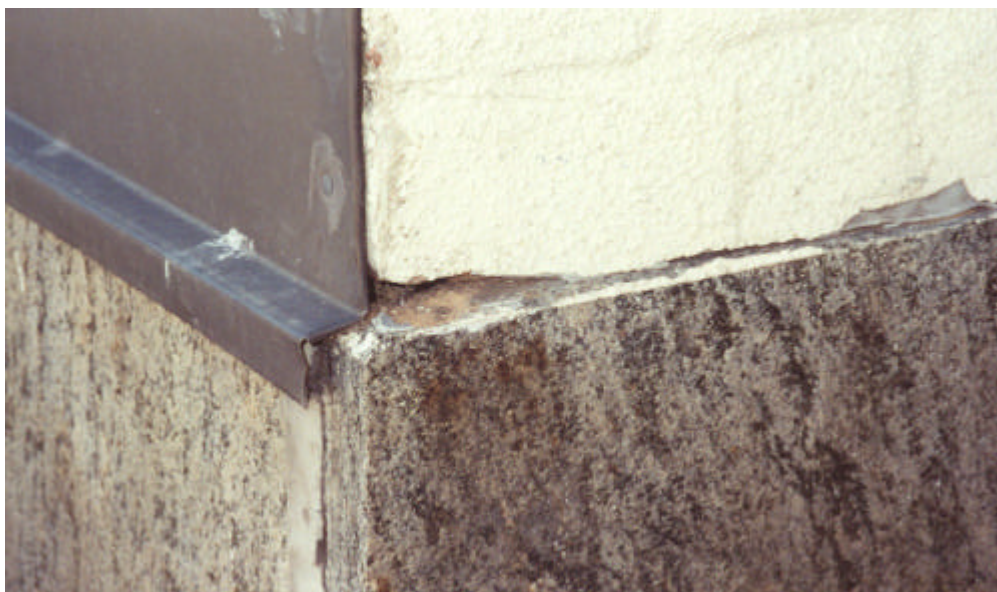
Bild av fog vid skada.
